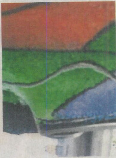
Ein geschwungener Riss zieht sich über einen Teil des Kunstwerks. FOTO: PECO
